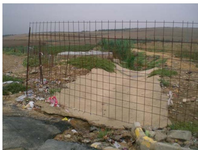
FOTOGRAFÍA III-32: Emisario y aliviadero en Avda. Ciudad de Tejada
