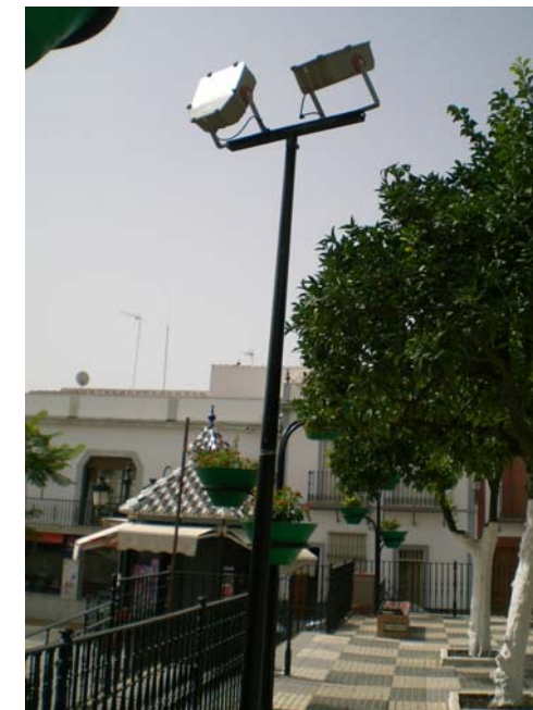
FOTOGRAFÍA III-56: Alumbrado monumental de Iglesia de S. Bartolomé a base de proyectores
