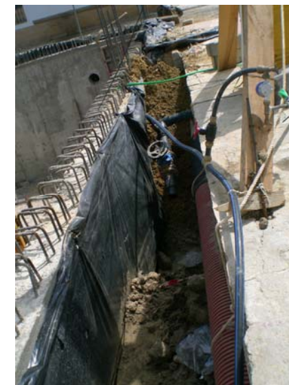
Fotografía III-65: Rotura y reparación provisional de la red, provocada por obra de particular en calle Humilladeros.
