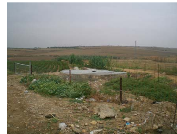
FOTOGRAFÍA III-68: Aliviadero de crecida en el emisario principal de Paterna
