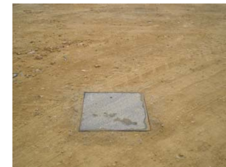
FOTOGRAFÍA III-50: Arqueta de registro de red de BT soterrada en Tujena
