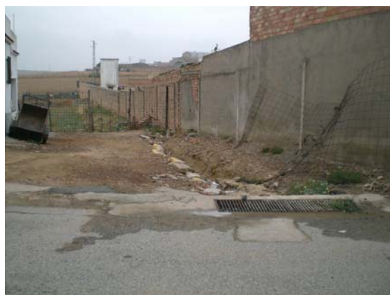
FOTOGRAFÍA III-69: Vertido incontrolado de la red en cruce de la calle Emigrantes y Avda. de la Libertad .
