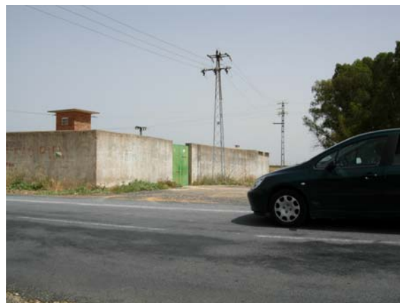
FOTOGRAFÍA III-25: Depósito auxiliar, situado al Noreste de la población, actualmente con uso en caso de emergencia
