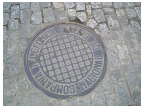
FOTOGRAFÍA III-59: Arqueta de Telefónica calle Plaza
