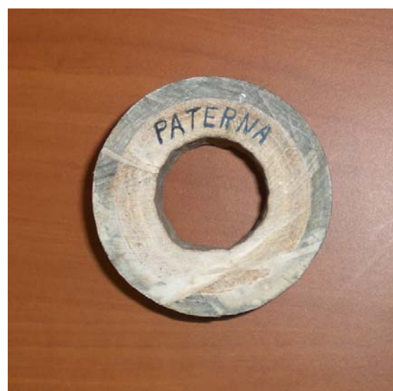
FOTOGRAFÍA III-63: Reducción del diámetro del conducto entre la captación de Zancudo y el depósito por colmatación de cal.
