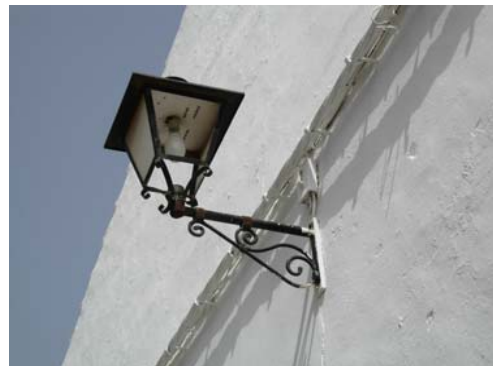
FOTOGRAFÍA III-51: Lámpara sin protección de vidrios de luminaria (c/ Forencia Monje)
