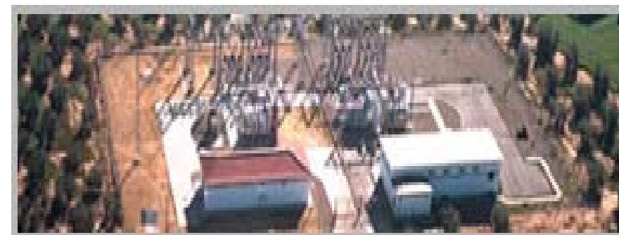
FOTOGRAFÍA III-46: Subestación de Santa Amelia
