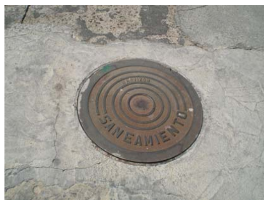
FOTOGRAFÍA III-35: Pozo de registro de la red de saneamiento
