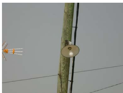
FOTOGRAFÍA III-52: Luminaria muy deteriorada en Tujena
